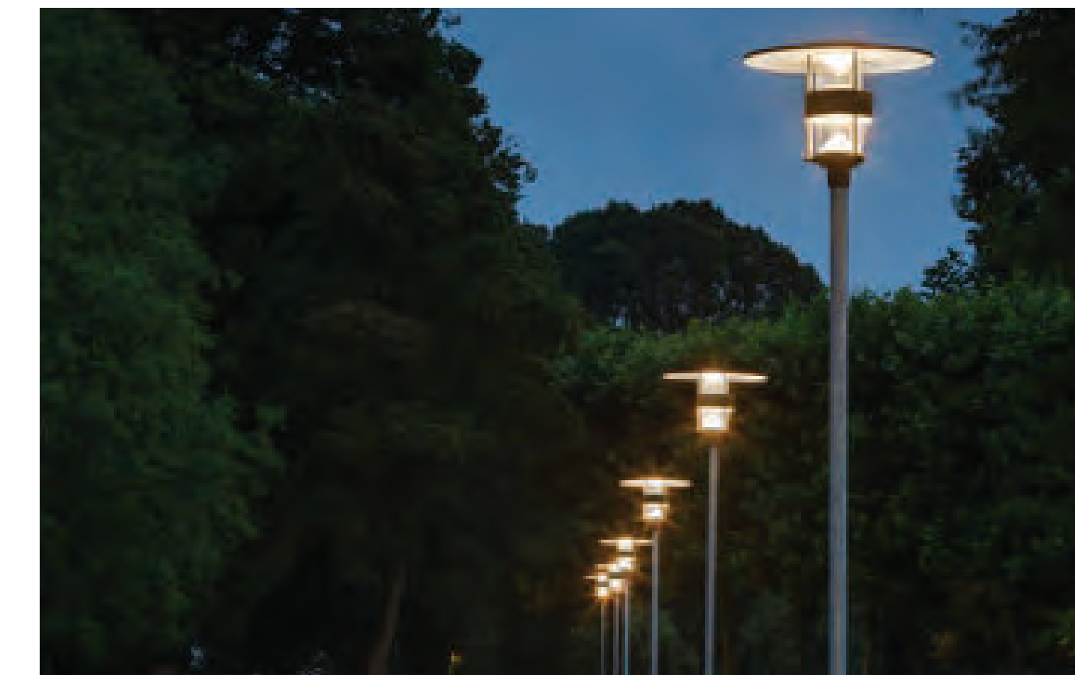
H Iluminación de caminos peatonales
